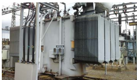
Läckande, nu åtgärdad, transformator
